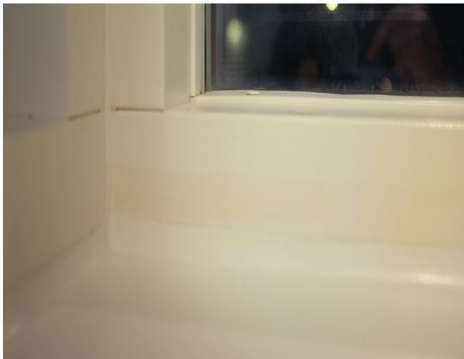
Fuge ind mod vindueskarm misfarves ved en reaktion med karmen. Fugen er kun misfarvet, der hvor den rammer karmen og kun nogle steder.
